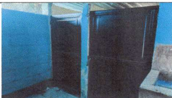
Foto 5: Sustrucción de puerta de servicios sanitarios
