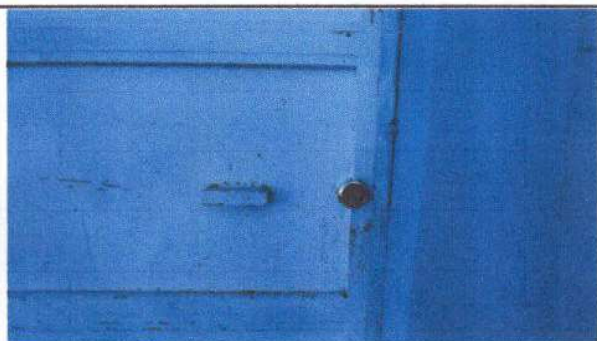
Foto 3: Sustrucción de chapa de puerta de cocina escolar
